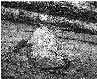
写真1 排出された木屑 鋸屑状で盛り上がる
