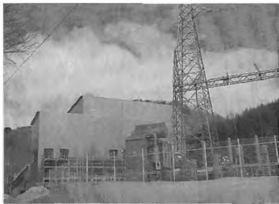
(株)ウツティかわい 木質バイオマス発電所
