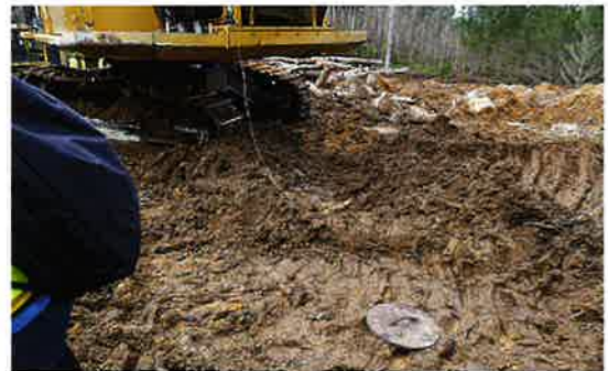
地面に埋設されたアンカーが抜けたり異常な動きを検知した場合、テザーシステムが自動停止＝「人が止める」のではなく機械が自動で止まるのだ！
